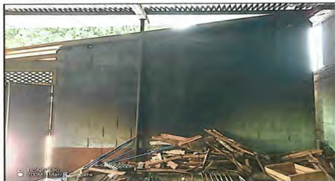
Foto 3: Paredes en mal estado por lo que se requiere mejoramiento de paredes de block, acabado en cocina + dirección
