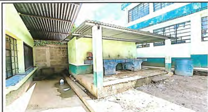
Foto 1: Solicitud de cambio de techo de lámina Aluzinc en área de cocina y patio
