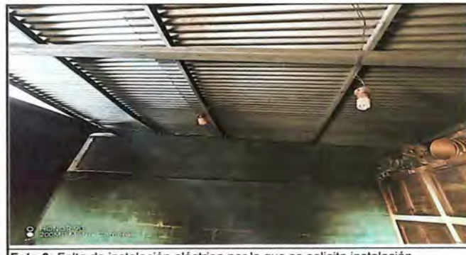
Foto 6: Falta de instalacion electrica por lo que se solicita instalacion iluminacion+tomacorrientes y aplicacion de pintura en área de cocina y dirección
